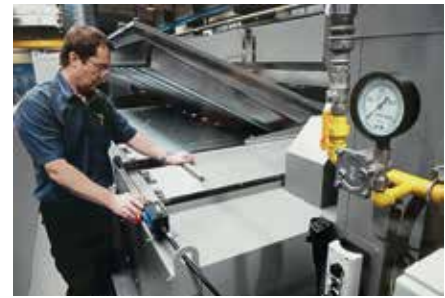
20 De flexorotatiedroogtunnel 'levert' optimaal solventverrijkte drooglucht aan de naverbrander. Dat helpt de naverbrander autotherm te functioneren (foto Bobst).
